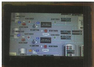
Figura 1 – Tablet executando IHM SCADA.
